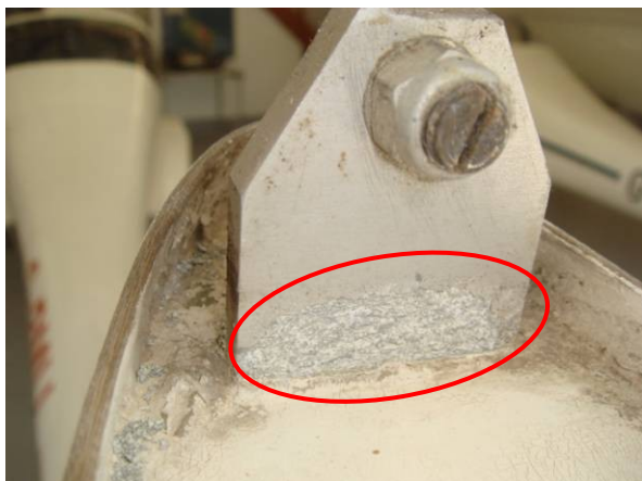
Fig. / Abb. 2 Corroded nose plate Korrodierte Nasenplatte
